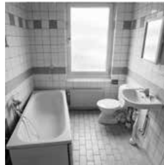
Bristande tätskikt bakom kakel, våtrumsmatta eller färg är vanligt förekommande i äldre flerbostadshus.
