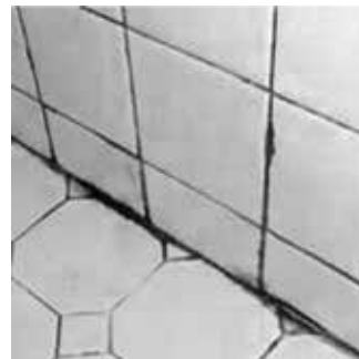
Fuktskador i badrum är ofta dyra och tar lång tid att åtgärda med den traditionella renoveringsmetoden.
